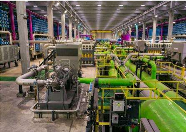
Planta de dessalinització del Llobregat (Aigües Ter Llobregat)
